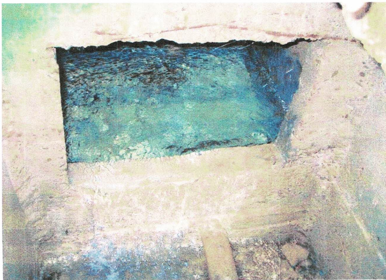
Фигура 4. Водната и сухата камера на каптажната шахта на извор „Куру дере 1“ с част от водовземната тръба - автор [13]
